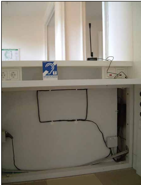
Induktive Höranlage als Kleinsystem hinter dem Rezeptionstresen
